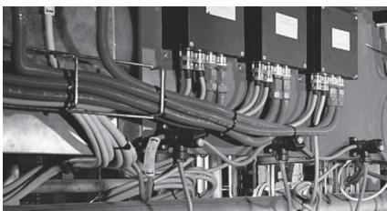
Protección de cableado para conexión de máquinas.
