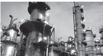
Protección y conducción de cableado en plantas petroquímicas, Oil&Gas, Químicas.
