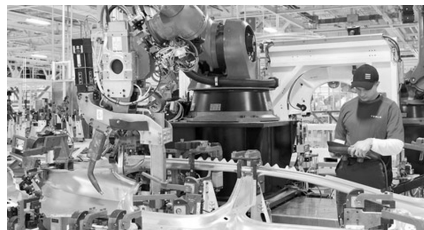
Protección de cableado en Instalaciones de Automatización, Electrónica y Robótica
