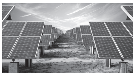
Protección y conducción de cableado en Plantas Solares de Estructura fija o Seguidores de Eje.
